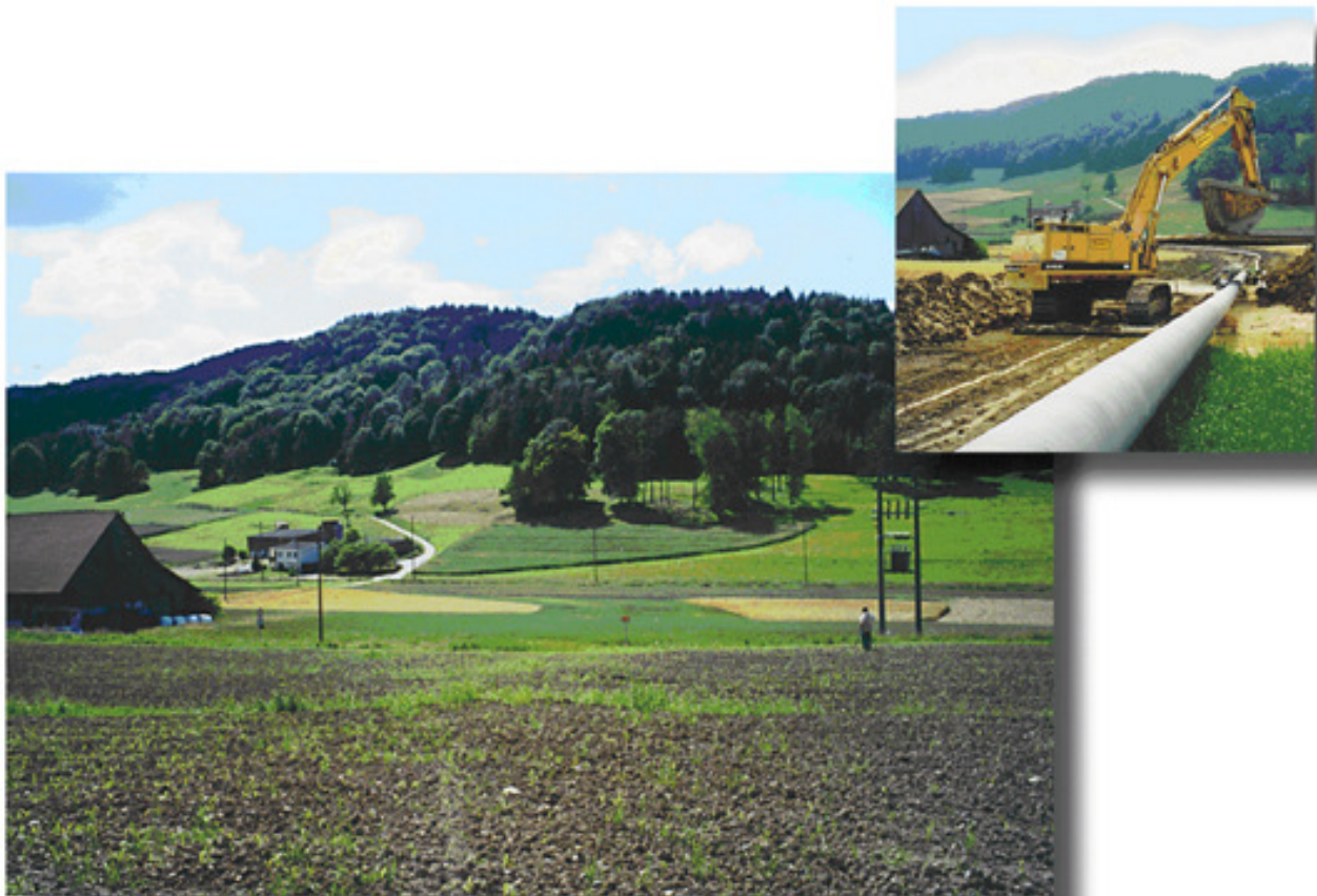
Der Bau einer Erdgasleitung oben rechts. Unten nach der Fertigstellung – nichts mehr zu sehen!
